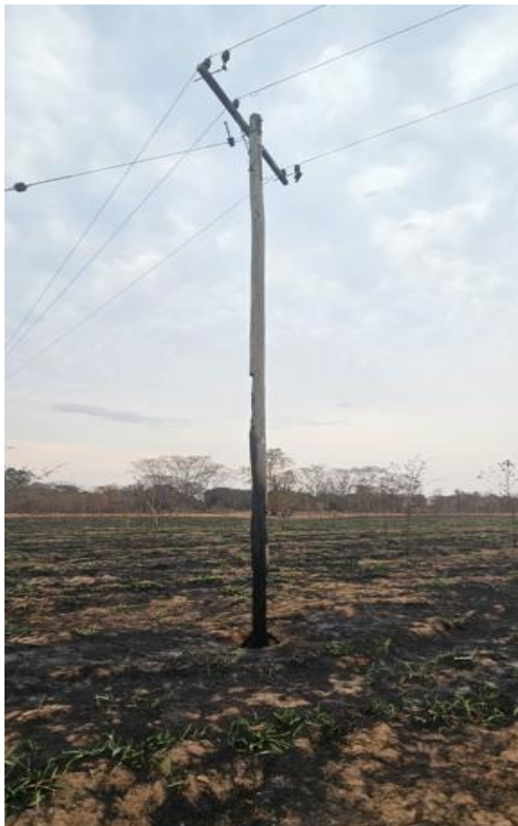
Figura 16 – Foto da ocorrência 2024- 1127995
