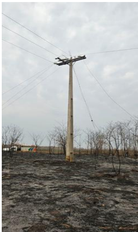
Figura 17 – Foto da ocorrência 2024- 1127995
