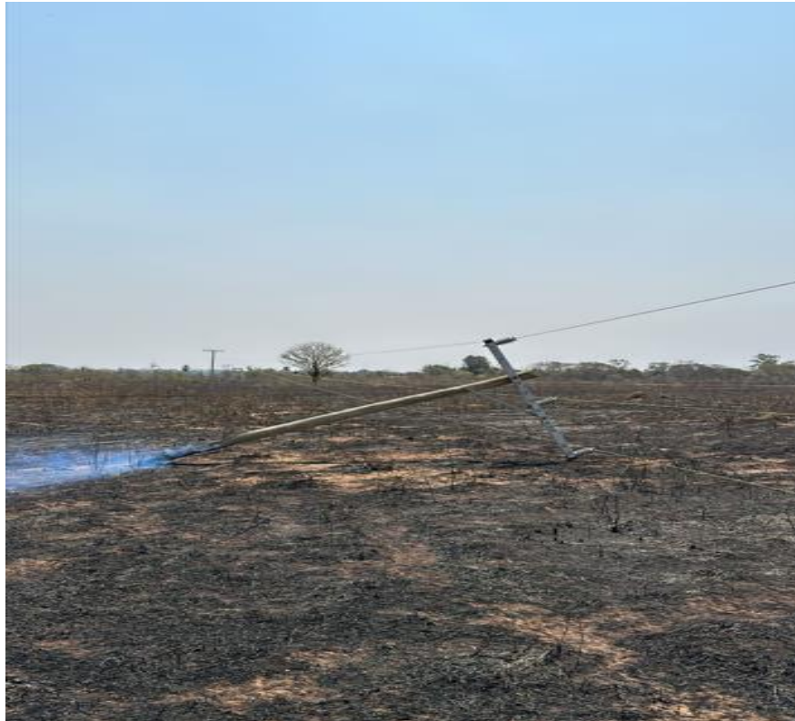
Figura 9 – Foto da ocorrência 2024- 1072102
