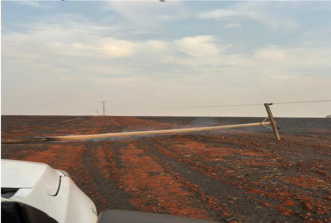
Figura 12 – Foto da ocorrência 2024- 1127674
