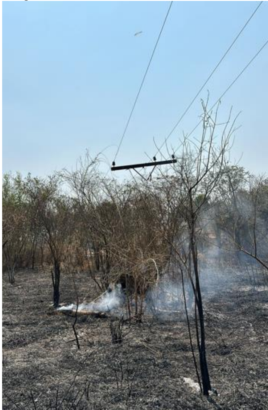
Figura 2 – Foto da ocorrência 2024- 1063491
