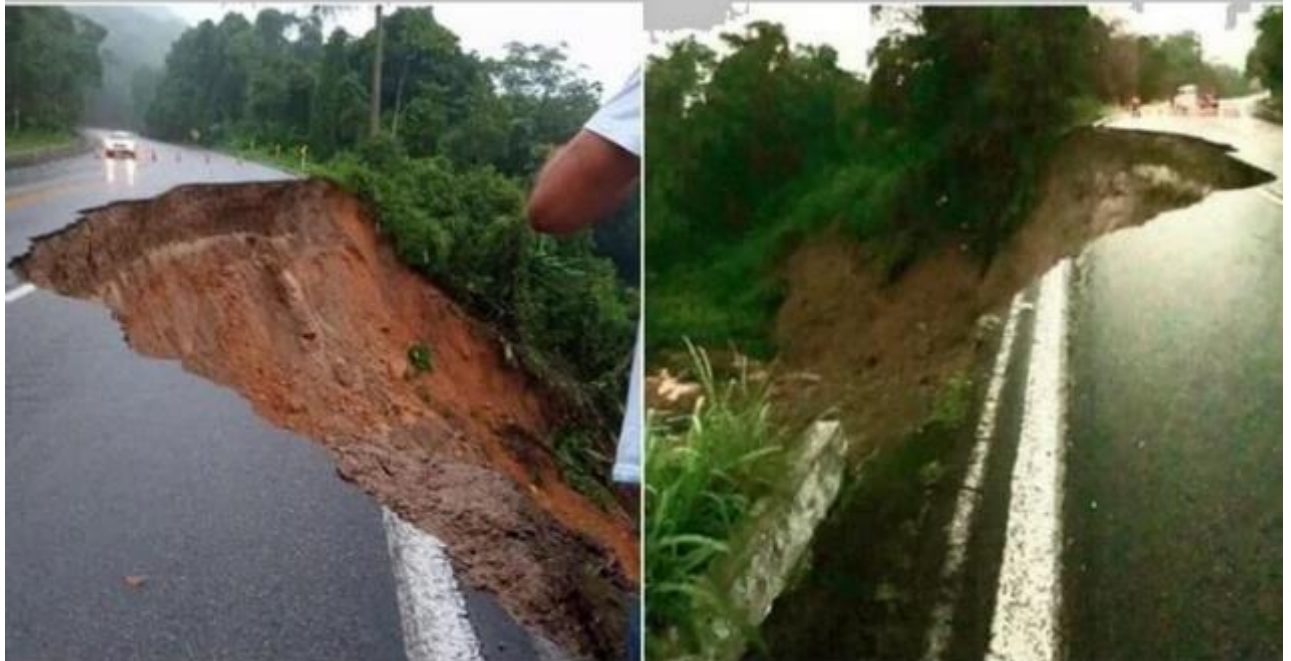
Figura 5 – Acesso impedido – OC. 2022-384801
