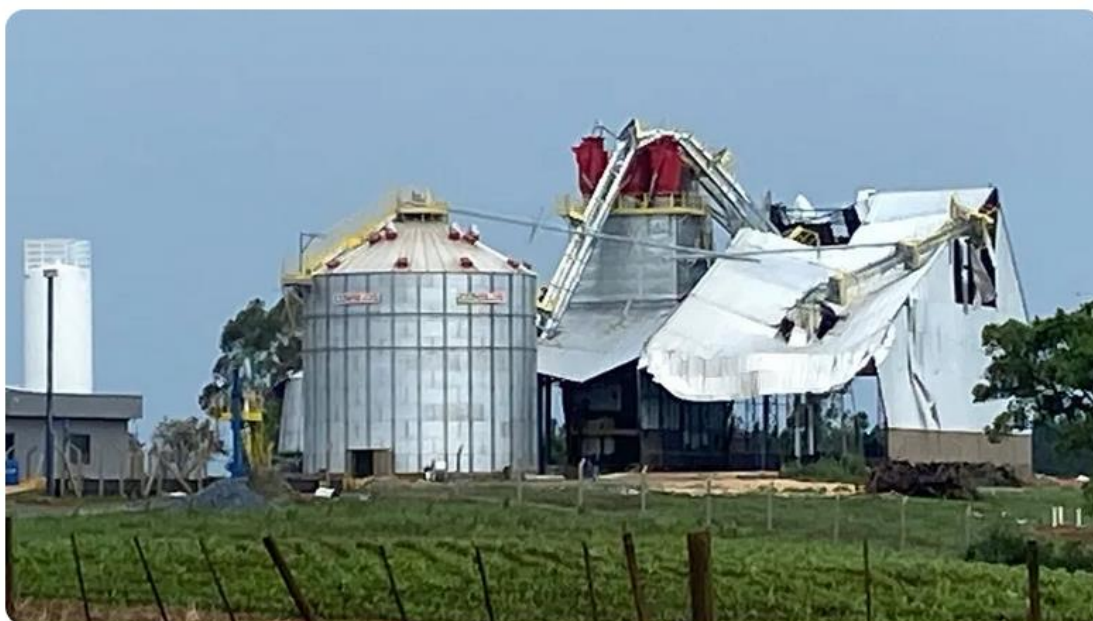
Em Itapeva (SP), um silo de grãos foi danificado pela tempestade — Foto: Arquivo pessoal
