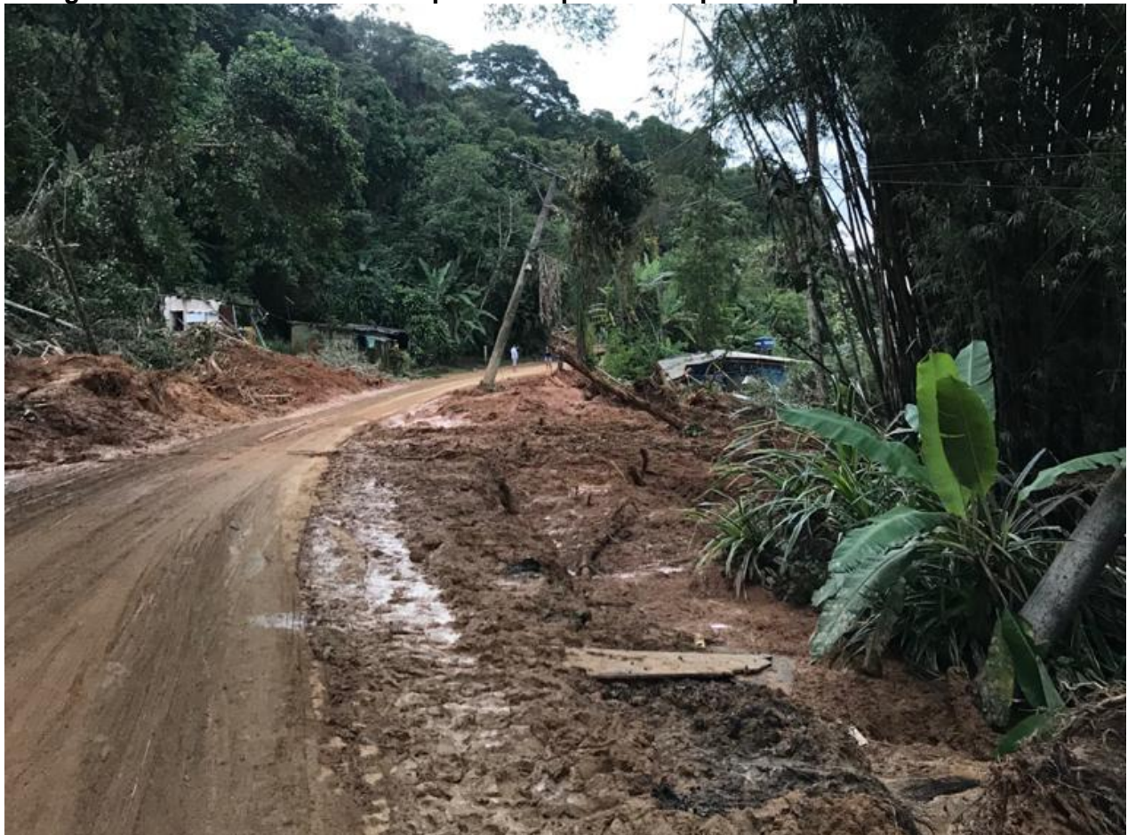
Figura 14 – Trecho da estrada após desimpedimento parcial pelo DER dia 04/03/2020
