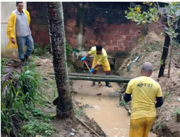
Tentativa de desobstrução por equipes da Prefeitura de Recife após chuva. — Foto: Reprodução/Redes Sociais
