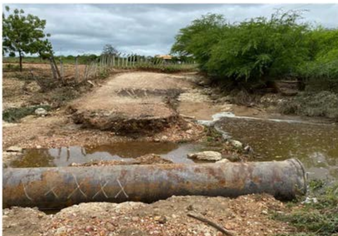
Estrada em Parnamirim fica bloqueada após chuva forte no município — Foto: Divulgação/Prefeitura Municipal de Parnamirim
