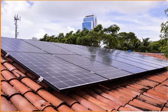
Módulos fotovoltaicos da Escola Assis Chateaubriand
