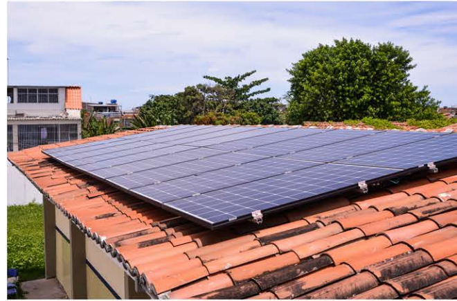
Módulos fotovoltaicos da Escola Alzira da Fonseca Breuel
