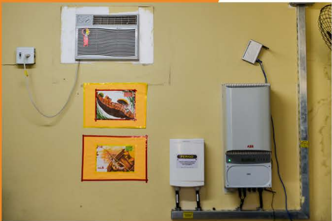
Condicionador de ar com selo Procel e inversor da Escola Assis Chateaubriand
