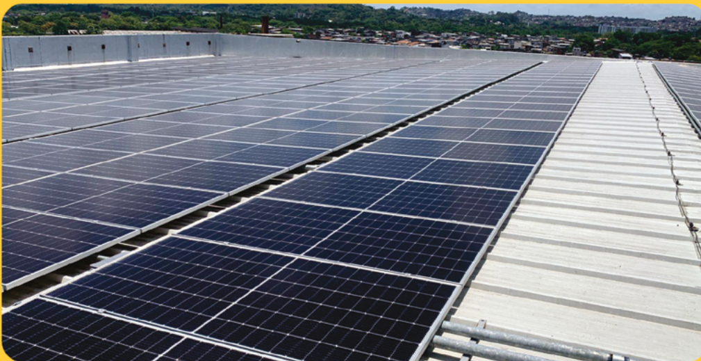
A usina solar gera uma economia de 90% no consumo de energia elétrica do hospital da Fundação
