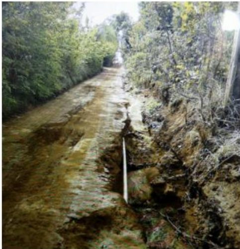
Chuvas intensas deixaram as vias danificadas | Fotos: GDF Presente
