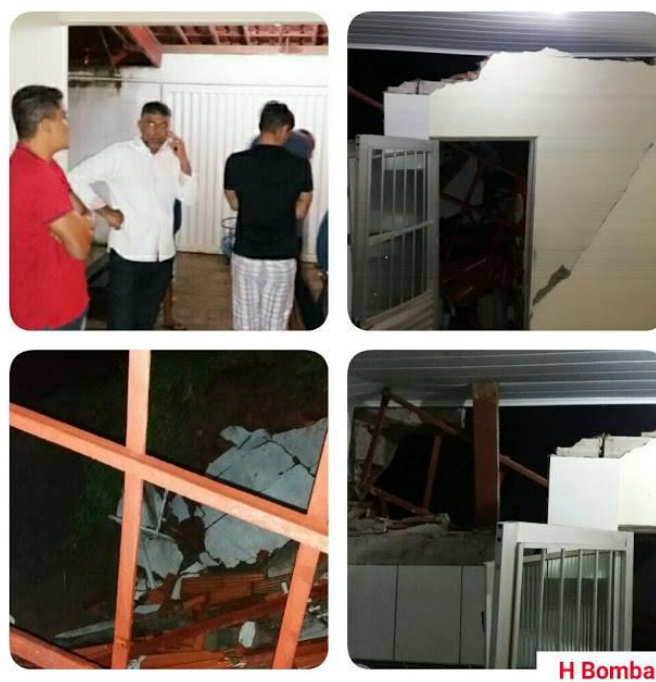
Figura 12 – Danos causados pelas chuvas em Itarantim
