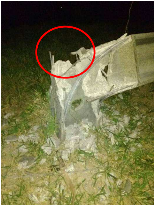
Figura 10 – Estrutura 68 Danificada Vista Frontal
