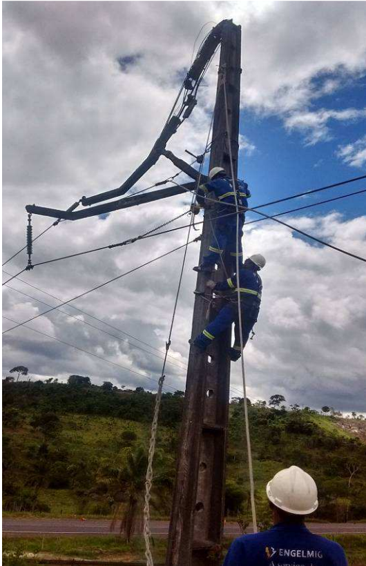
Figura 18 – Estrutura com Dano na Parte Superior
