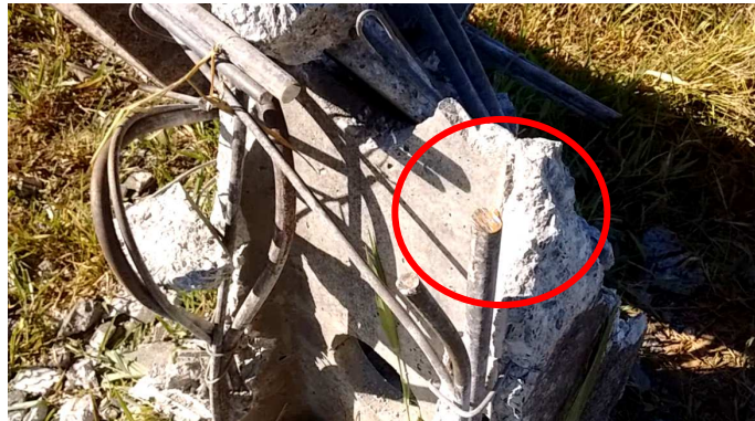
Figura 11 – Ferragem da Estrutura 68 seccionada
