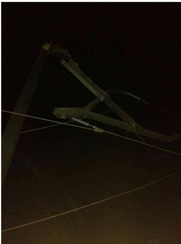
Figura 8 – Estrutura 66 Tipo CAR Danificada
