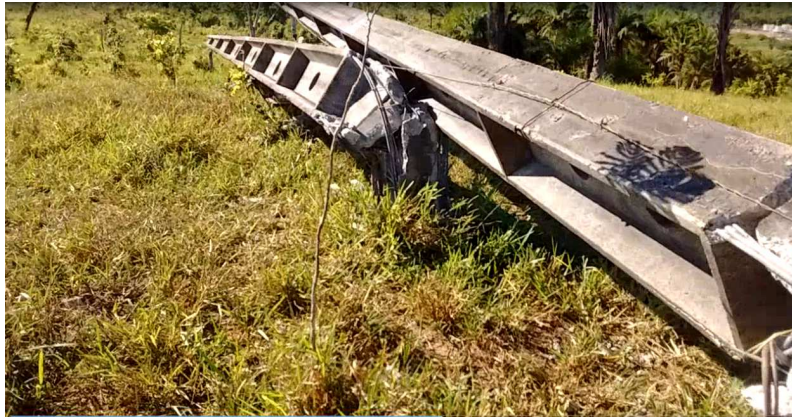
Figura 9 – Postes da Estrutura 68 Avariados
