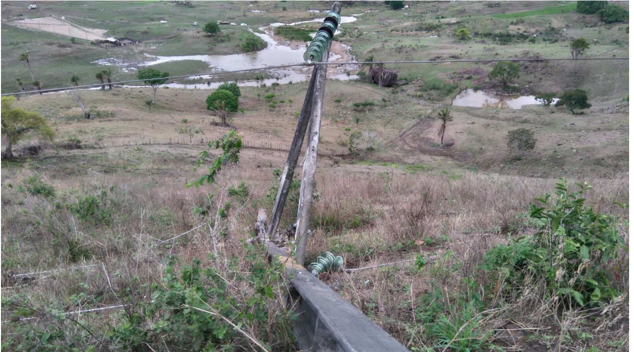
Figura 12: Estrutura da LD 138 kV que foi ao Solo.
