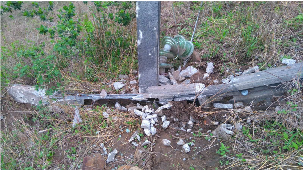
Figura 13: Detalhes dos danos na estruturada da LD 138 kV
