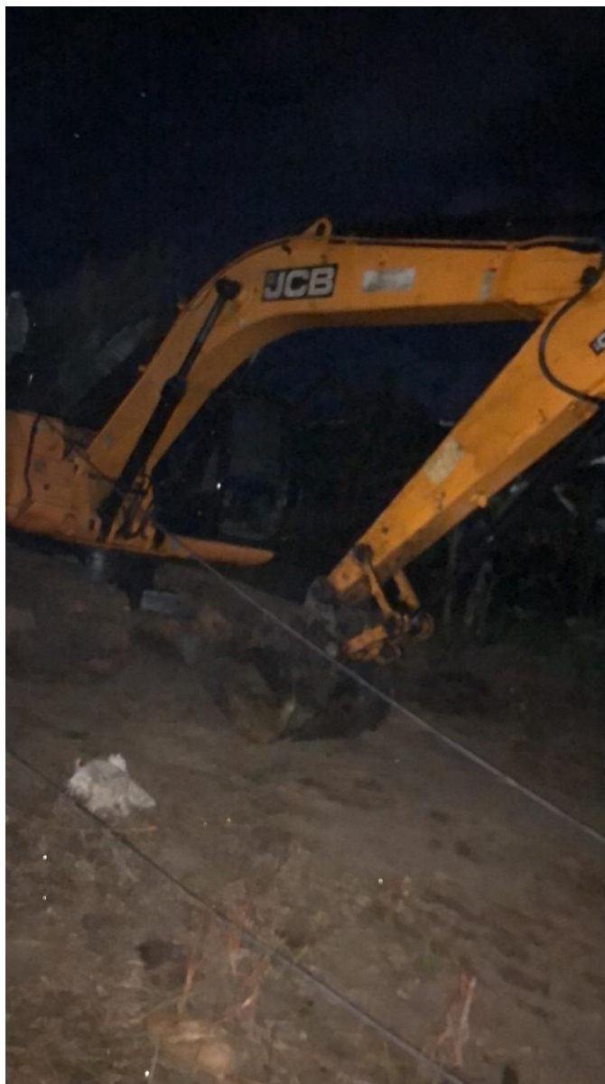
Figura 3 – Trator encontrado embaixo da LT com cabos sobrepostos no equipamento.
