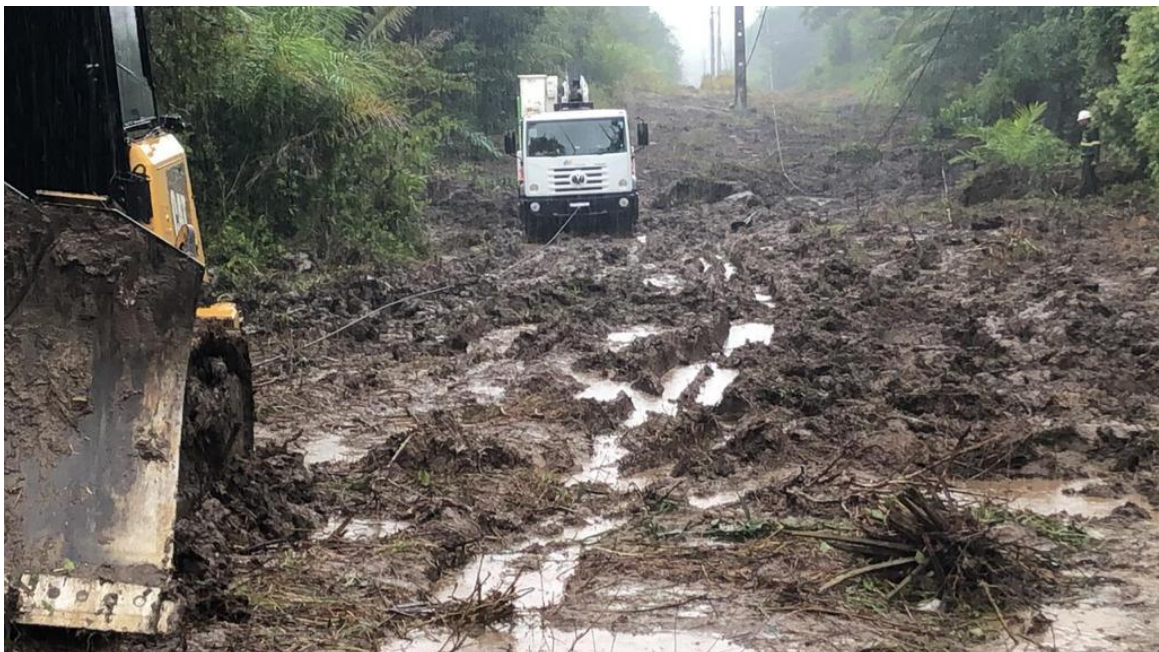
Figura 24 – Dificuldade para chegar ao local devido a lama (2).
