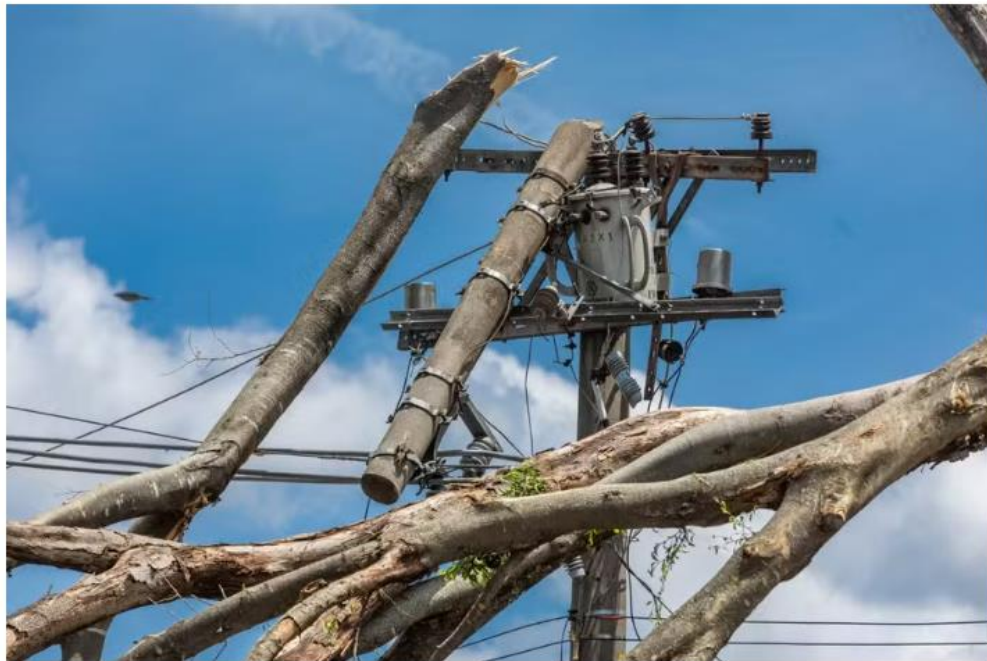
Poste destruído por árvore derrubada por tempestade no bairro do Campo Limpo, em São Paulo (SP) — Foto: Edilson Dantas/Agência O GLOBO
