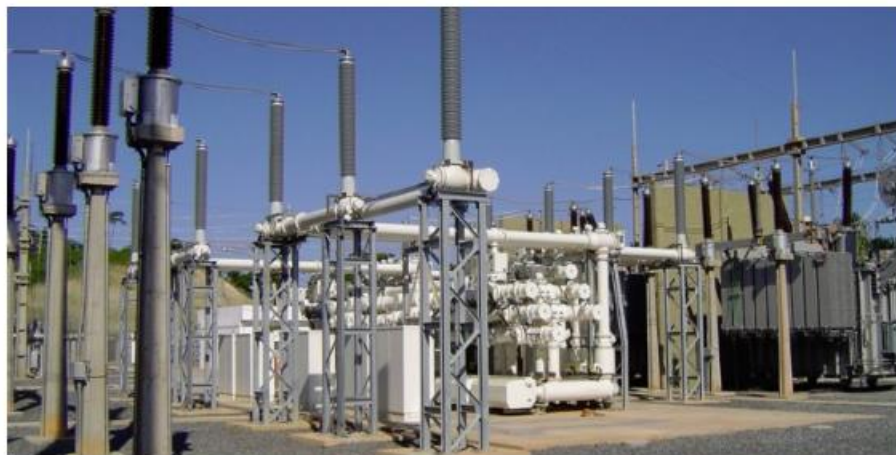
Equipe de profissionais mobilizada para reparar os danos e trazer a luz de volta para os municípios | FOTO: Reprodução/GovBA |
