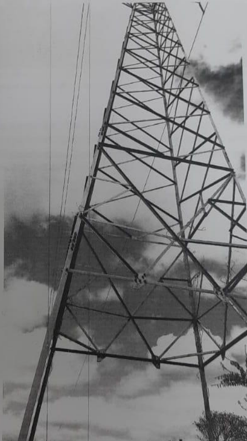
Fotografia 02. Evidenciando a ausência das barras metálicas que compunham a estrutura da torre 1/1.
