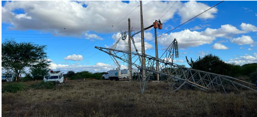
Figura 20 – Registro do poste encontrado no dia do evento.
