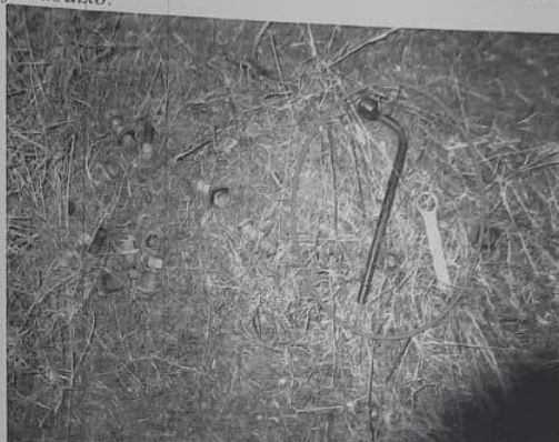
Fotografia 06. Ferramentas abandonadas próximo à base da torre 1/3 .
